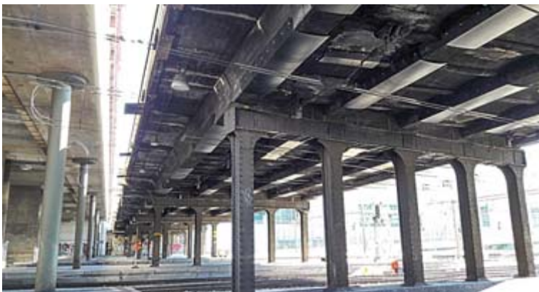
Wie auf den Fotos vom Juni 2019 unschwer zu erkennen, hat der Zahn der Zeit an der Brücke genagt. Grund dafür ist insbesondere, dass das Abdichtungssystem unterdessen Mängel aufweist. Die Brückenplatte besteht aus fünf Stahl-Hauptträgern. Diese sind untereinander mittels Stahl-Querträgern (Trägerrost) verbunden.
